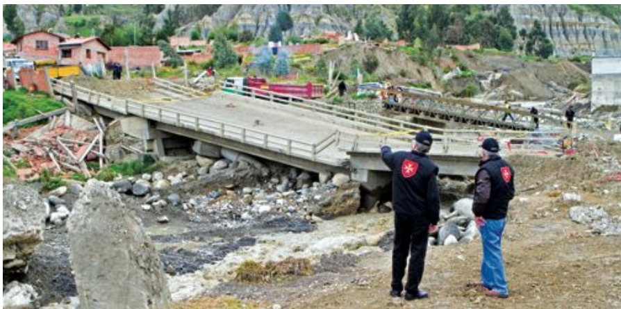
■ Inspection des dégâts créés par les inondations en Bolivie.
